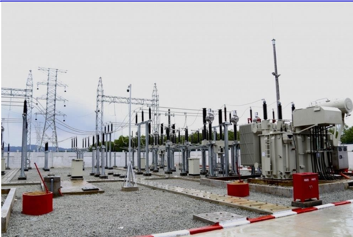
TRẠM 110kV HÀM CƯỜNG 2
