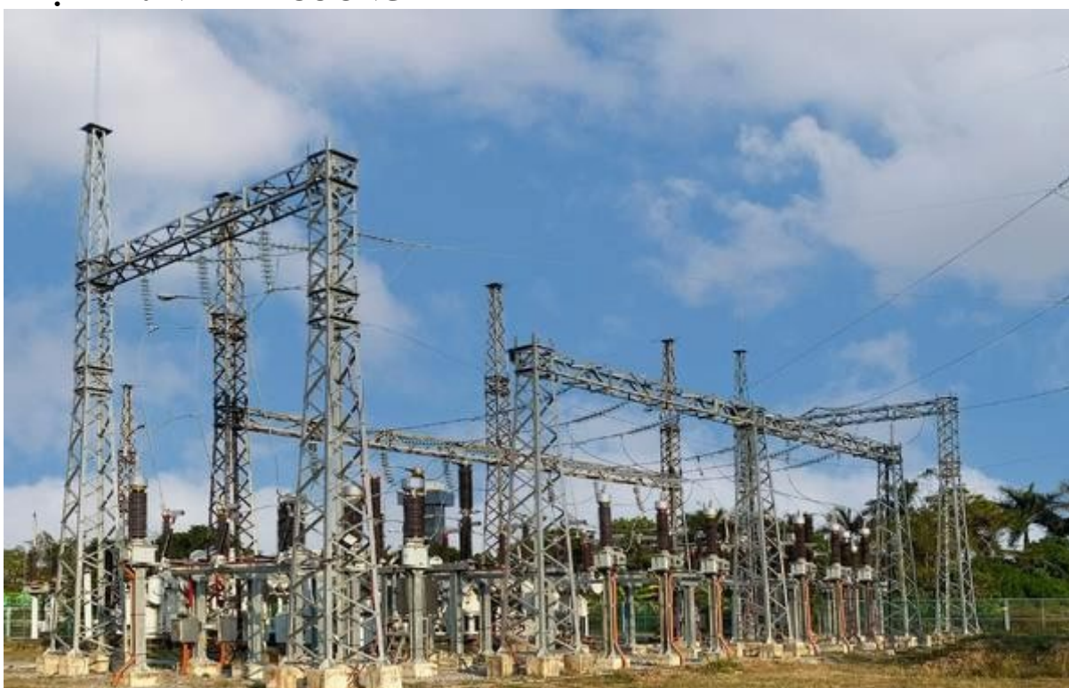
TRẠM 110kV LÀO CAI 2
